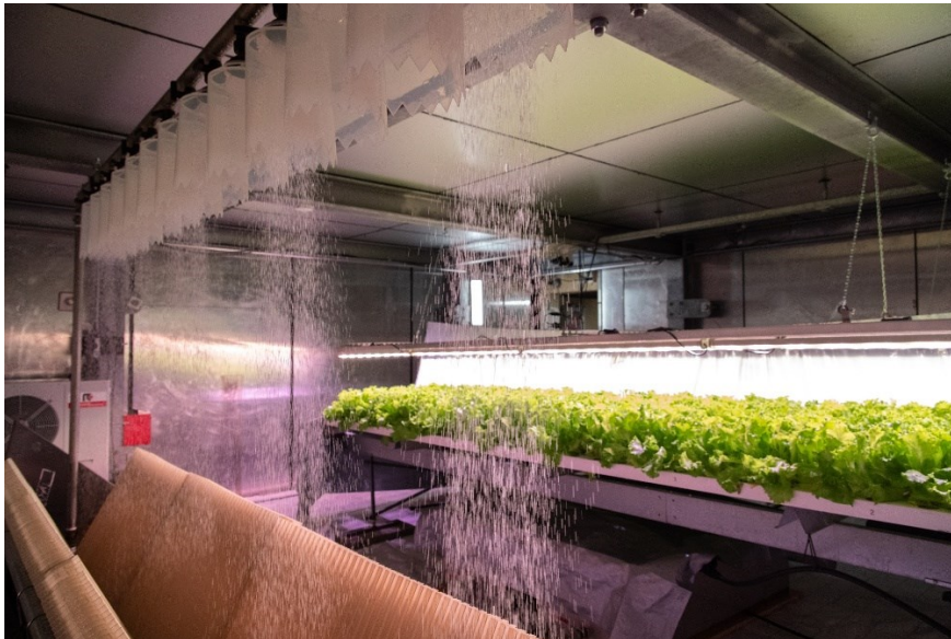
Kuva 3. VIS-koekasvuhuoneen sisätila salaatinkasvatuskokeiden aikana keväällä 2021.
